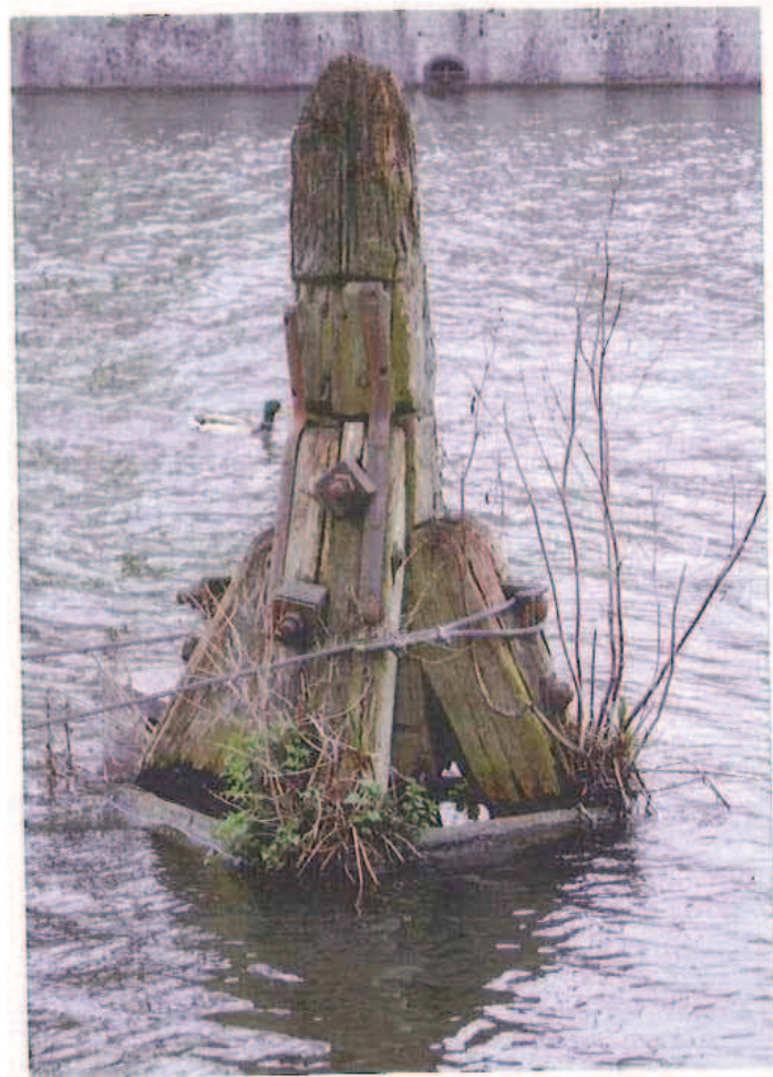
Gewoon verwaarloosd ☹ Conserveren. Moet niet vervangen worden door een nieuwe
